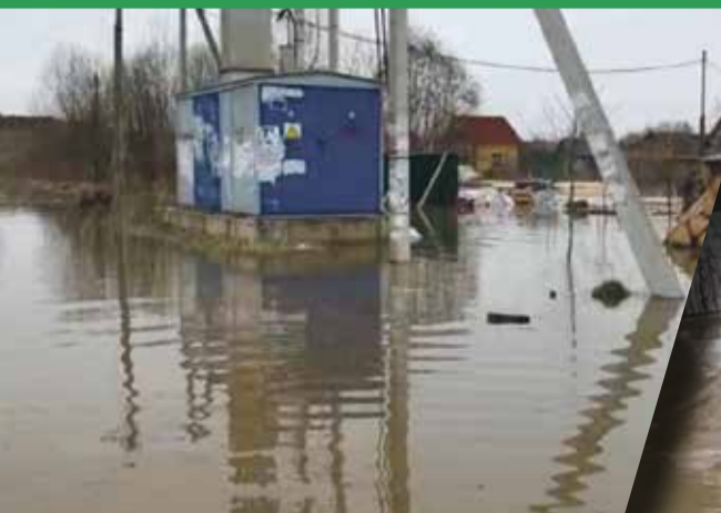
Затопило и подстанцию
