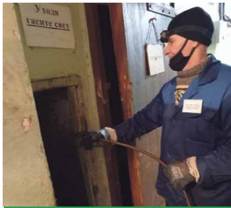
Устранение очередной аварии
