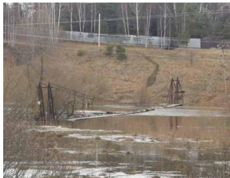
► Насколько сильно пострадал мост в Сатино будет ясно после снижения уровня воды.
