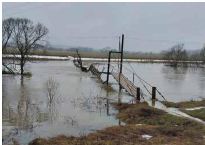
► Мост в Совхозе Боровский не пережил паводок
