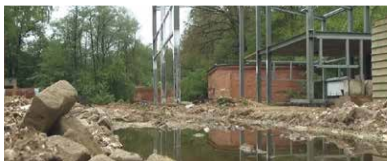
■ На месте строительства КНС в Старом городе царит запустение
