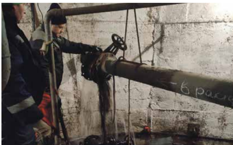
■ Инженерные сети давно нуждаются в модернизации
