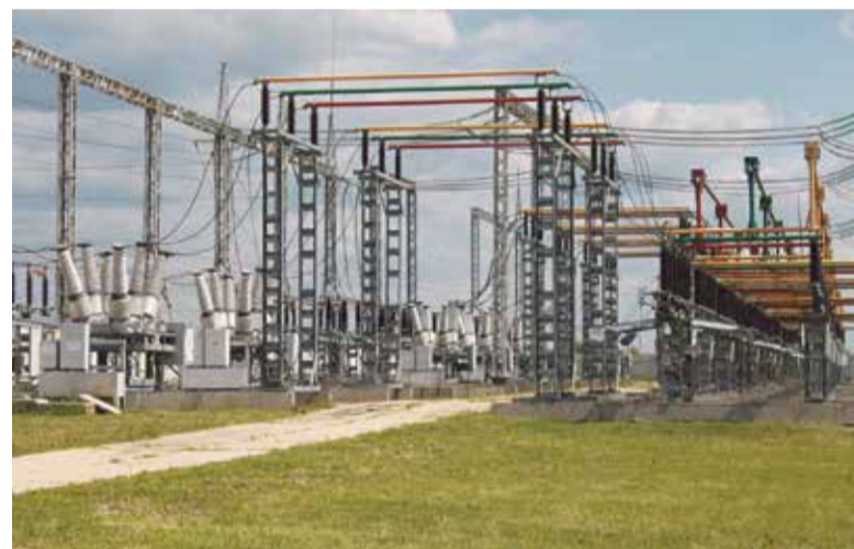
■ Скачки напряжения могут быть из-за неполадок на подстанции
