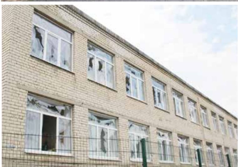
■ Все школы Первомайска повреждены. Сейчас специалисты Калужской области работают совместно с первомайскими и восстанавливают здания
