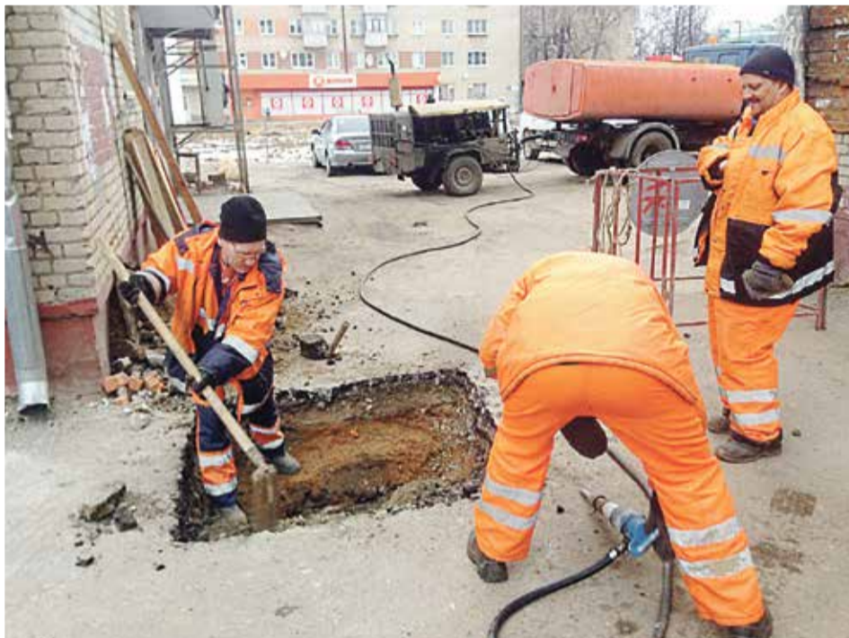
■ Ливневку нужно периодически ремонтировать
