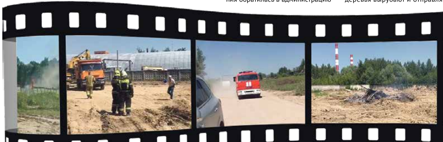
■ На стройплощадке будущего завода устроили костёр, чтобы сжечь отходы после вырубки деревьев
