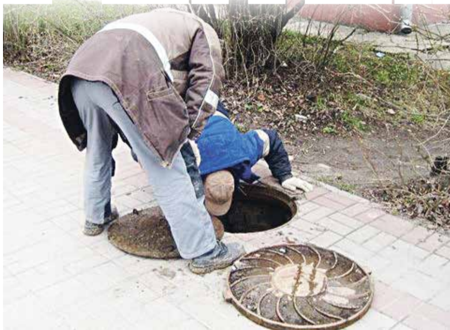
Канализационные колодцы должны быть всегда закрыты
