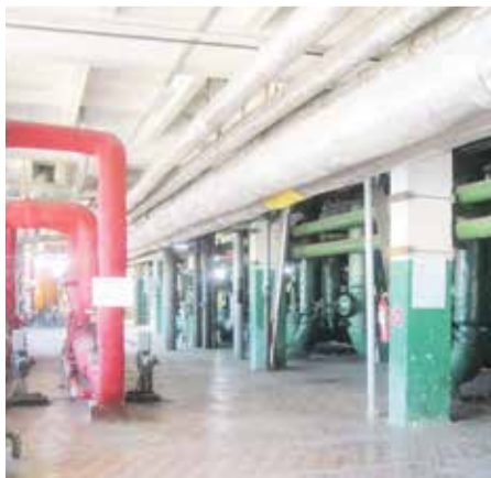
■ Внутри городской котельной
