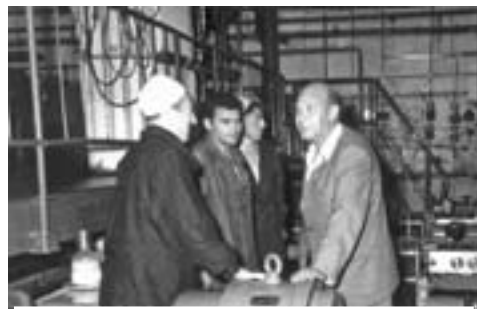
● В помещении подпиточных насосов. Слева направо: 1. Н.Р. Разин, 2. В.В. Малинин, 4. Д.И. Блохинцев
